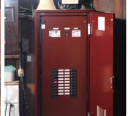
本堂（国宝）の分電盤の中に設置
