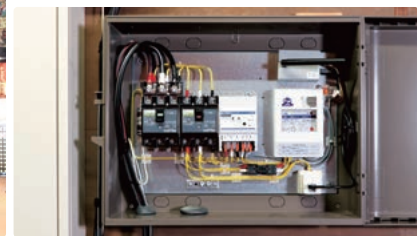
御社殿（国宝）に電気を供給する分電盤の横に機器設置（渡廊）
