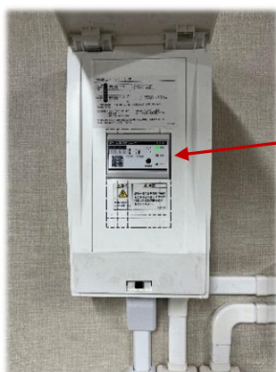
放電検出ユニット （スパークテクト） 搭載ユニット
