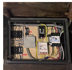
主屋の梁近くに設置
